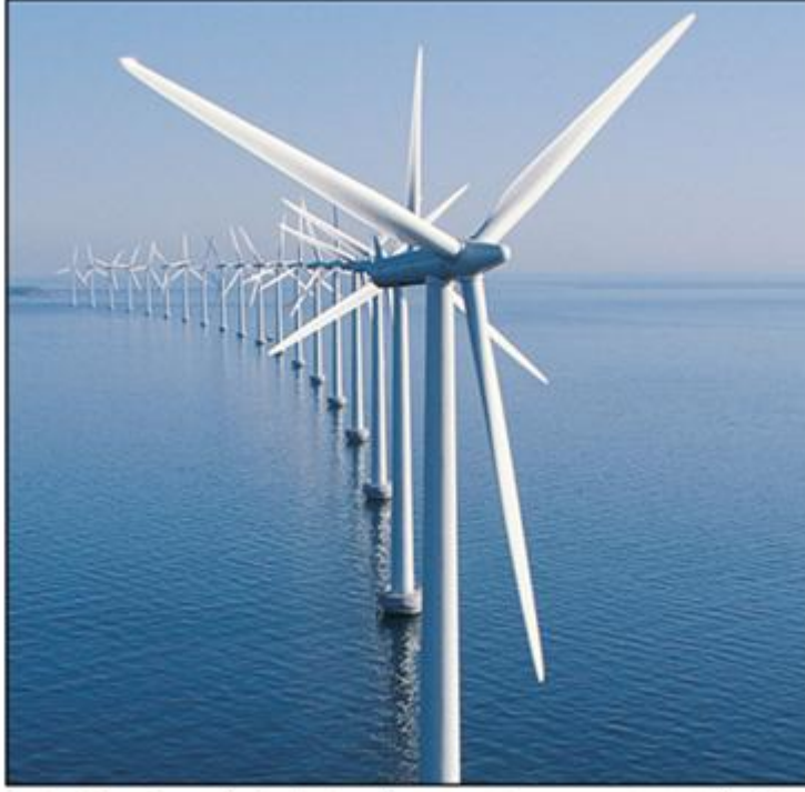
الشكل رقم (٣٤) : توربينات تم تركيبها داخل البحر في الدنمارك
