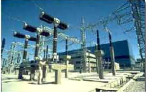
شكل (١٨): صورة لمحطة محولات
