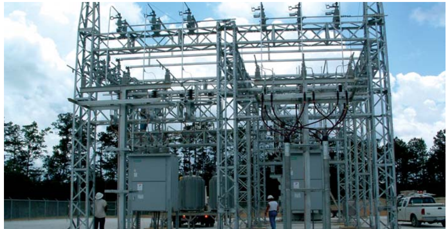
محول كهربائي ضخم في محطة الشبكة الكهربائية
