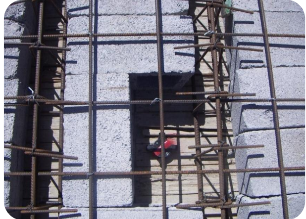
صوره (٢-١٨٤) توضح فصمة الطوب لعلبة الكهرباء - بحث عام ٢٠١٢-٢٠١٣م
