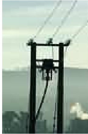
شكل (11) برج نهاية خط النقل
